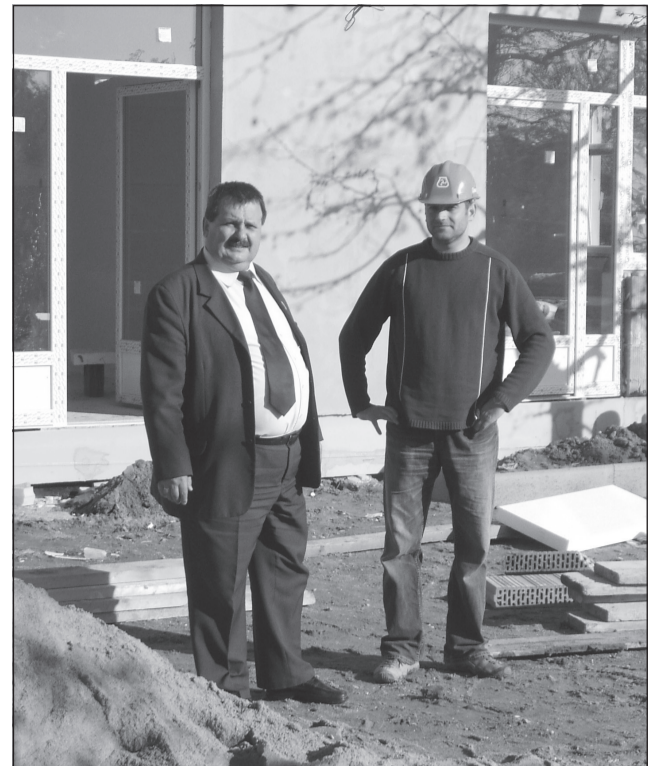
A terveknek megfelelő ütemben halad a fűzesgyarmati óvoda építése. Várkonyi Imre polgármester a helyszínen a munkavezetővel egyeztet.
